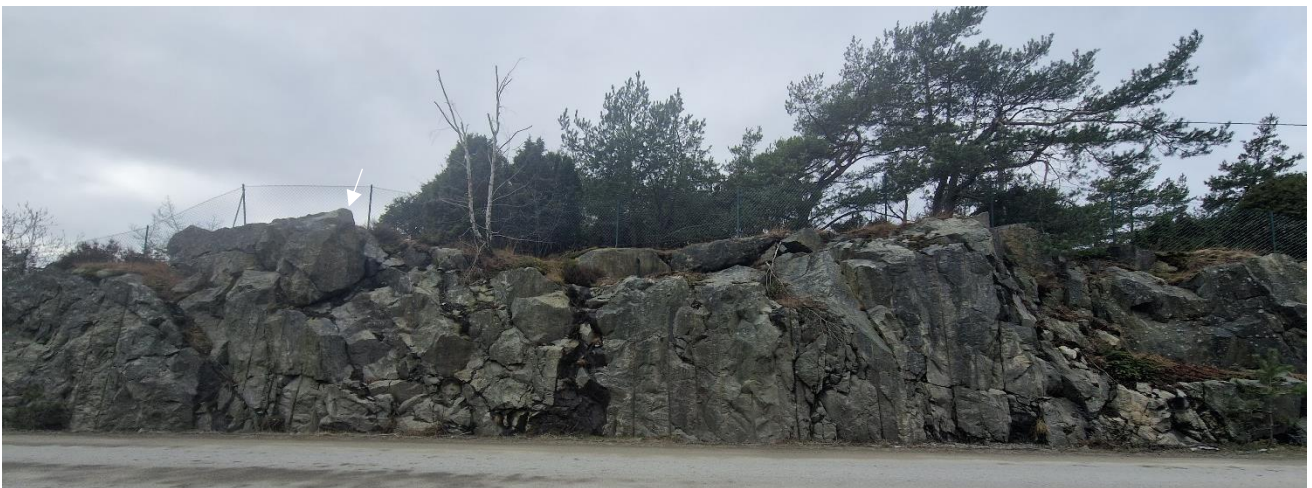
Figur 10. Bergslänt 4, vy från öst. Block i behov av förstärkning markerat med vit pil.
