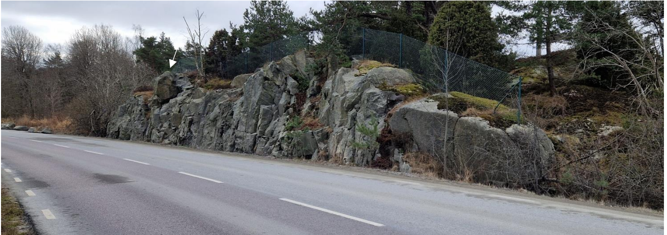
Figur 9. Bergslänt 4, vy från nordöst. Block i behov av förstärkning markerat med vit pil.
